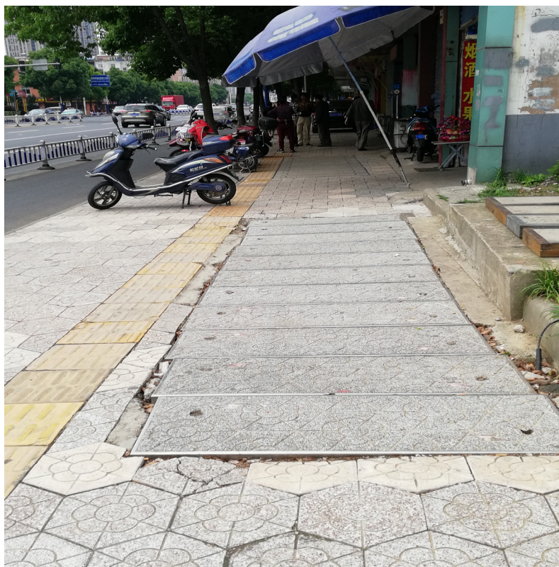
人行道板上的电缆井
